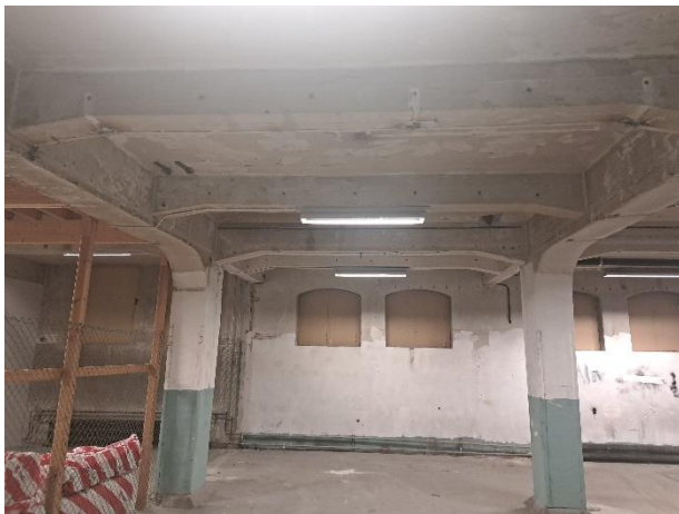
Foto 5 Vybild över scenario 2 med betongpelare/balkar samt platsgjuten betong. Sotbeläggningar förekommer
