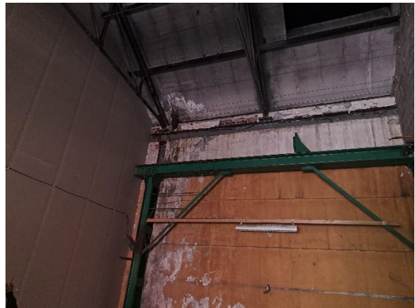
Foto 10 Skador pga. inläckage vid takgenomföring scenario 3.
