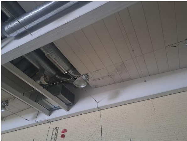
Foto 3 Lättbetongplank med fuktrosor, dock svårt att fastställa från marknivå
