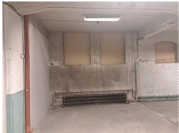
Foto 6 Sotbeläggningar på källarvägg
