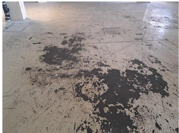
Foto 2 målad betong som även den ser kontaminerad ut i scenario 2
