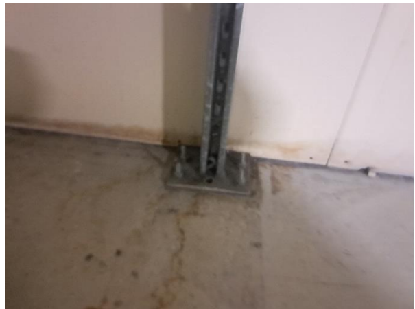
Foto 4 Uppsug i lättvägg (spånskiva) med synliga mögelskador
